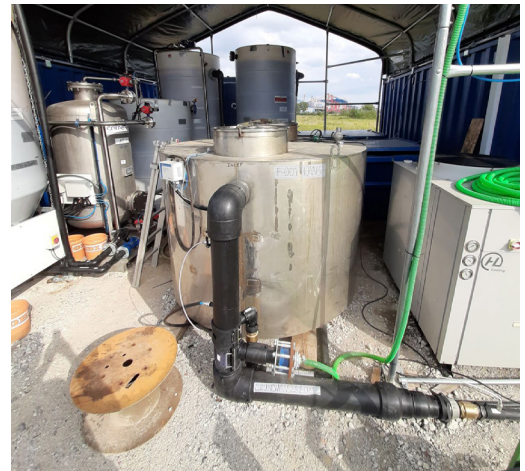
Ausschnitt aus der Grundwasserreinigungsanlage
